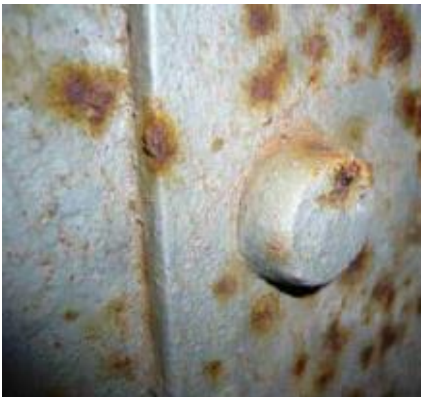
Inspectie in Mei 2007 (voor applicatie van ZINGA ) Merk de toegenomen balkcorrosie op.
