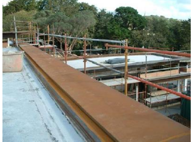
Zicht van bovenzijde van het afdak/balkon langs de voorkant van het huis
