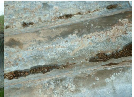
Les creux dans la galvanisation à chaud étaient très profonds
