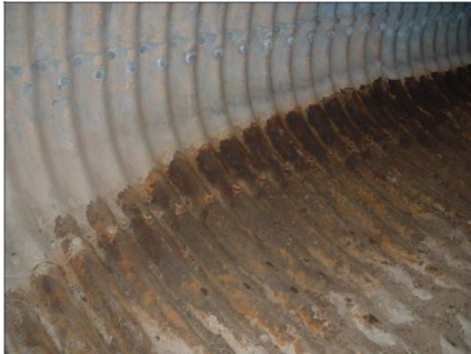
Caniveaux rouillés à cause des nitrates dans l'eau des champs.
